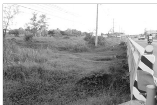
1 น้ำเสียและตะกอนไหลมารวมในที่ต่ำ ทำให้คลองตันเขิน น้ำที่ทิ้งจากหอพัก กิจการร้านค้าในเขตพื้นที่ชุมชนท่าขอนยาง ไหลมารวมกันบริเวณใต้สะพานบริเวณห้วยน้ำตก อัตราการไหลช้า น้ำมีสีดำเข้ม มีไขมันลอยบนผิวน้ำ น้ำเสียจากบริเวณนี้ไหลเข้าสู่คูน้ำต่อไป
